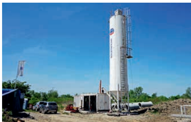
Ryc. 3. Stacja mieszania spoiwa hydraulicznego
