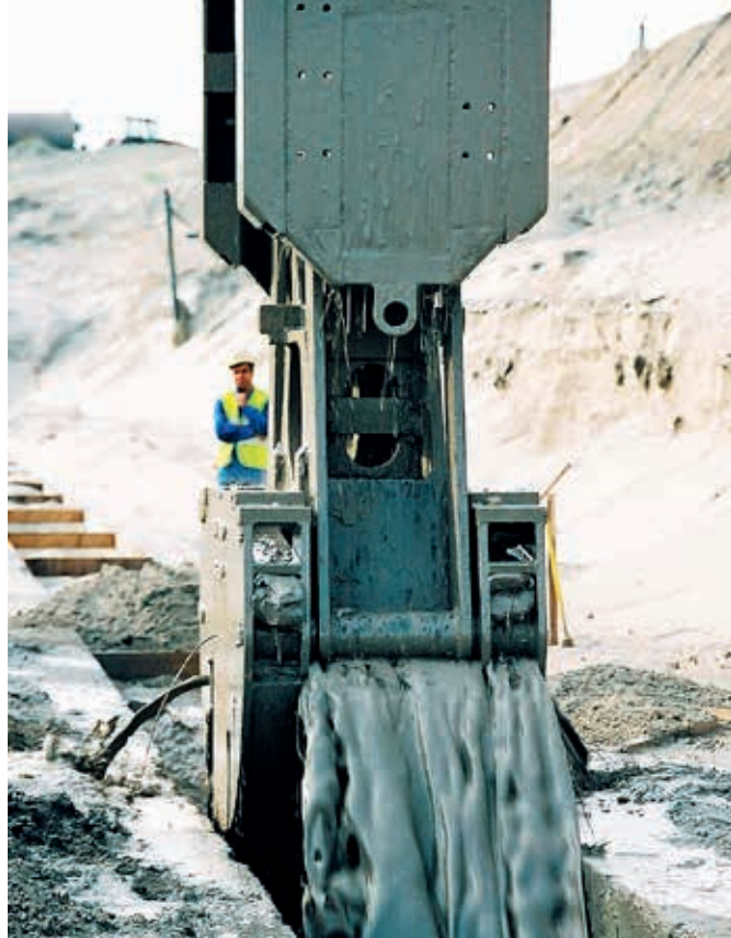
Przegrody przeciwnofiltracyjne wykonywane w technologii jednofazowych ścianek szczelnych, fot. Górażdże Cement SA
