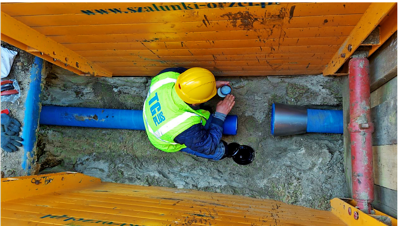
W złotej klatce, fot. vonRoll hydro Polska Sp. z o.o.
