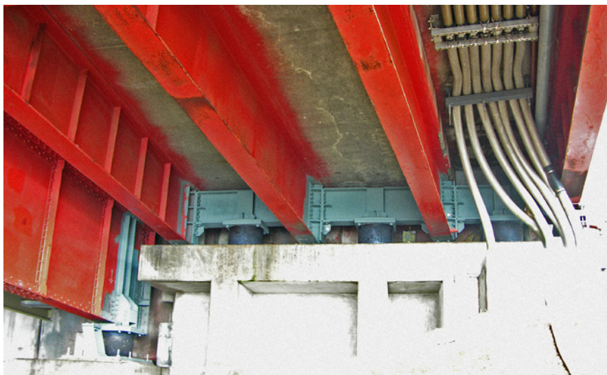
Zabezpieczenie sejsmiczne pomostu, fot. K. Dąbrowiecki
