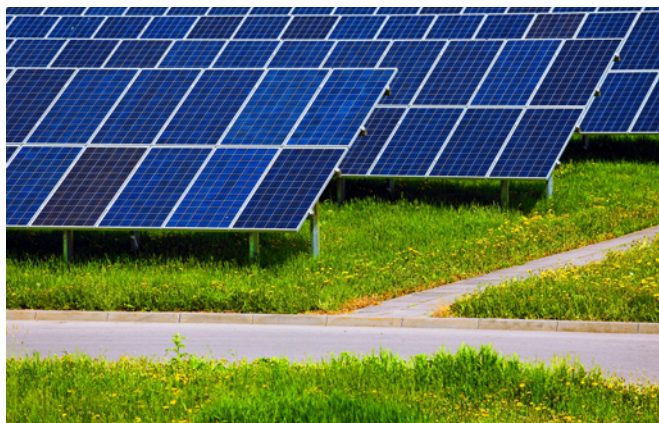
Farma fotowoltaiczna w oczyszczalni Płaszów
