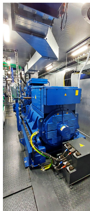
Generator napędzany silnikiem gazowym
