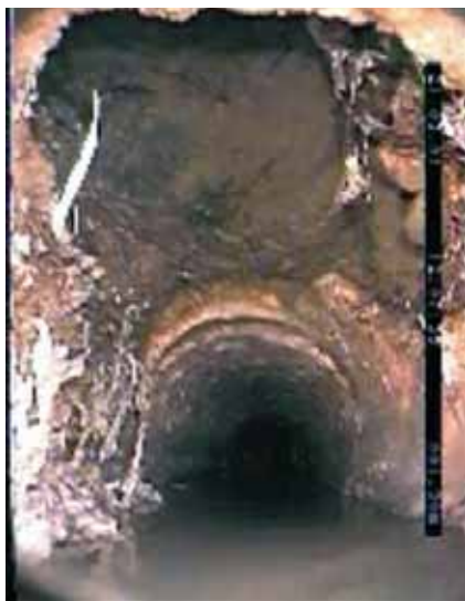
Rys. 13. Zdjęcie dużej pustki powietrznej nad wierzchołkiem uszkodzonego kanału [11]; w widoku (a) oraz po skierowaniu kamery w kierunku wnętrza pustki powietrznej (b)
