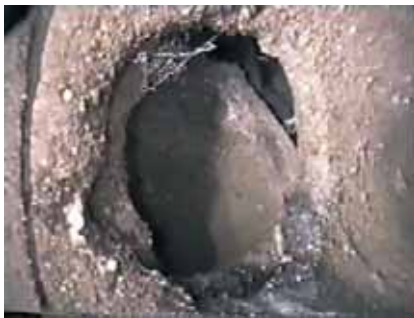
Rys. 22. Nieszczelne podłączenie przykanalika z widocznym gruntem na zewnątrz kanału [11]
