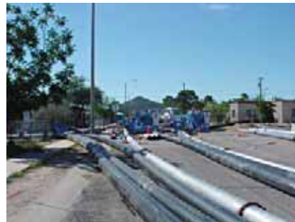
Rys. 9. Napowietrznie ułożone rurociągi transportujące ścieki z terenu zapadliska [10]
