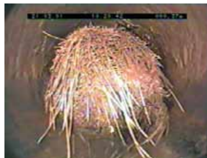
Rys. 33. Korzenie przerastające przez złącze rur w całości wypełniającej przekrój poprzeczny kanału [11]
