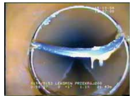
Rys. 18. Wypadnięcie uszczelki gumowej z części obwodu złącza rur [11]
