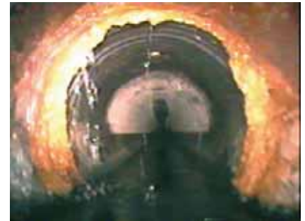
Rys. 28. Infiltracja wody gruntowej z narostem infiltracyjnym w miejscu nieszczelnego połączenia rur z tworzyw sztucznych zastosowanych do bezwypukowego uszczelnienia nieszczelnego kanału [11]
