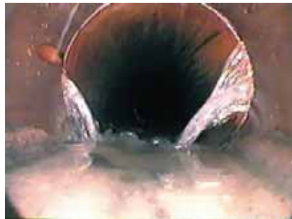
Rys. 29. Infiltracja ścieków sanitarnych do wnętrza badanego nieszczelnego kanału eksfiltrujących wcześniej z wyżej usytuowanego nieszczelnego kanału do otoczenia zewnątrzkanalowego, a następnie ponownie wpływających do przedmiotowego kanału [11]
