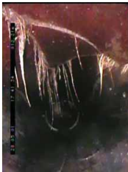
Rys. 30. Przerosty korzeni w miejscach spękań rury [11]
