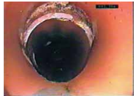
Rys. 17. Przemieszczenia poprzeczne rur odsłaniające grunt na zewnątrz kanału [11]
