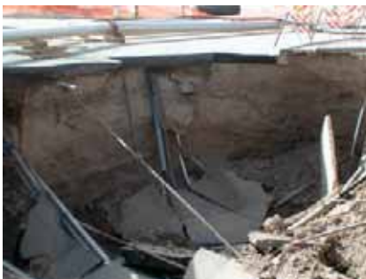
Rys. 6. Widok na fragment zapadliska z uszkodzonymi przewodami podziemnymi w Tucson [10]
