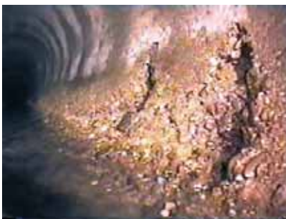
Rys. 23. Lokalne głębokie wżery korozyjne w kanale betonowym odsłaniające w dłuższym okresie czasu grunt po zewnętrznej stronie kanału [11]
