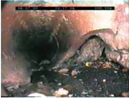
Rys. 20. Ubytek fragmentu rury z przedostającym się do wnętrza gruntem [11]
