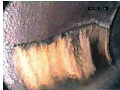
Rys. 25. Narosty infiltracyjne świadczące o okresowej infiltracji wód gruntowych do wnętrza kanału przez pęknięcie w rurze [11]
