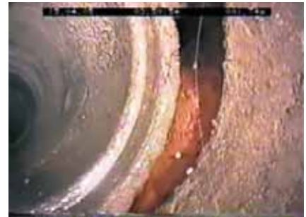
Rys. 16. Przemieszczenie rur w kierunku osiowym odsłaniające grunt na zewnątrz kanału [11]
