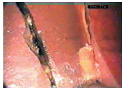
Rys. 19. Pęknięcie rury z odsłonięciem gruntu na zewnątrz kanału [11]
