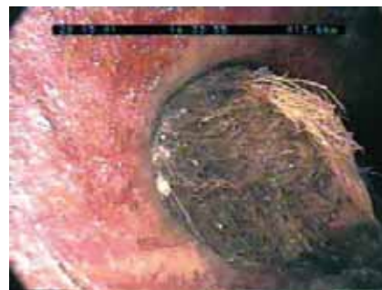
Rys. 32. Korzenie w całości wypełniającej wnętrze przykanalika [11]
