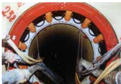
Rys. 8. Widok pośredniej stacji przeciskowej od wewnątrz rurociągu [3]
