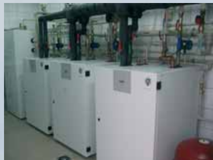
Instalacja pomp ciepła w Oczyszczalni Ścieków „Komorowice” w Bielsku-Białej
