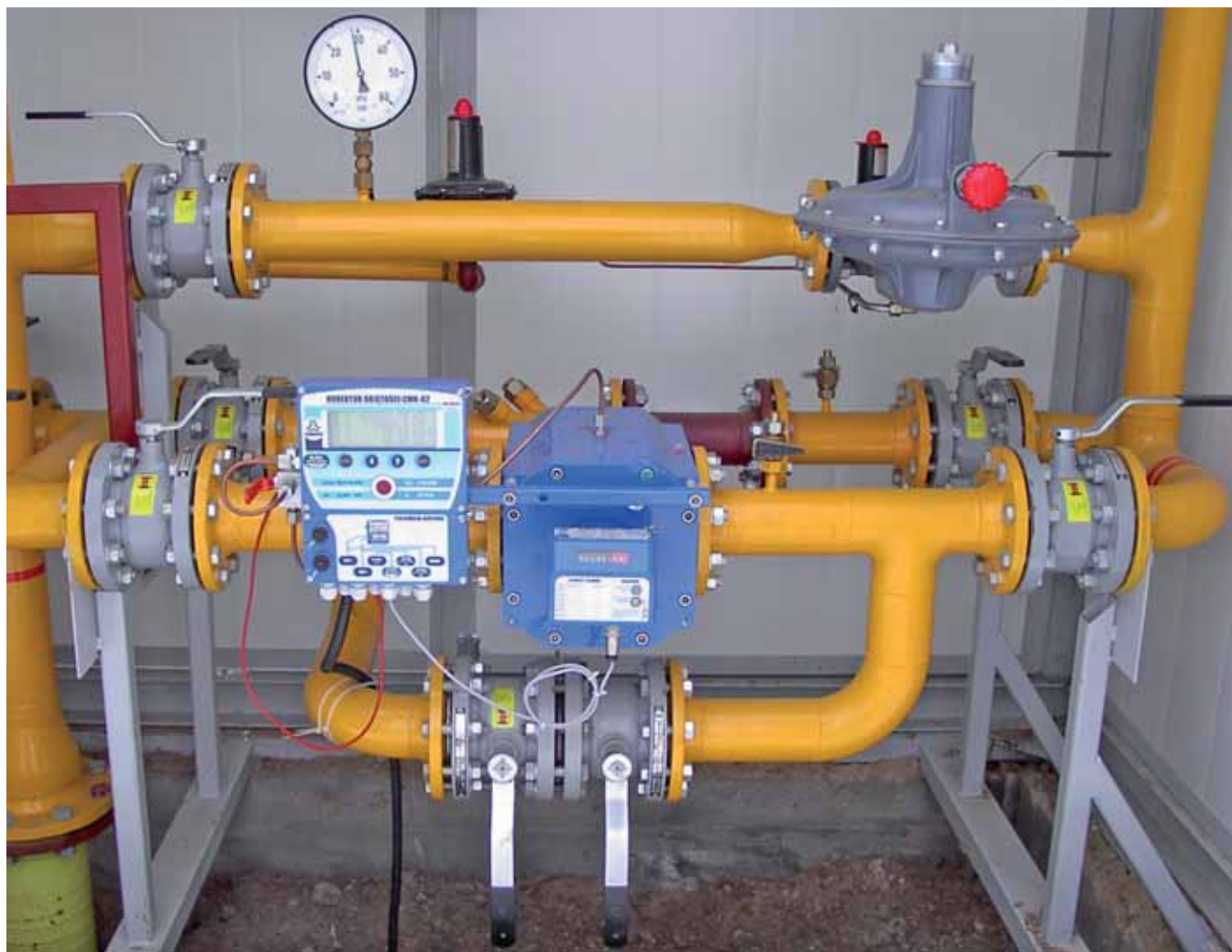
Stacja redukcyjna gazu, archiwum Gazowni Serwis Sp. z o.o.
