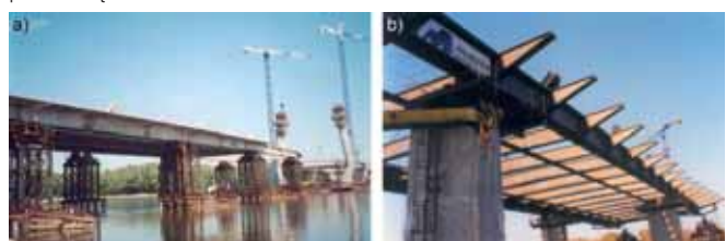
Rys. 9. Nasuwanie podłużne przęsła: a) mostu Siekierkowskiego w Warszawie [18], b) mostu Świętokrzyskiego w Warszawie [1]
