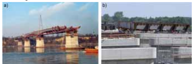
Rys. 7. Nasuwanie podłużne konstrukcji stalowej przęsła: a) mostu przez Wisłę w Wyszogrodzie (fot. BBR), b) mostu przez Wartę w ciągu autostrady A2
