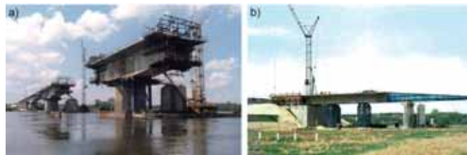
Rys. 5. Most autostradowy przez Wisłę w Toruniu: a) w trakcie betonowania wspornikowego przęsła w części nurtowej, b) w trakcie nasuwania przęsła w części zalewowej
