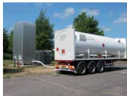
Ryc. 10. Instalacja LNG tymczasowego zasilania. Zasilanie poza stacją redukcyjno-pomiarową I stopnia
