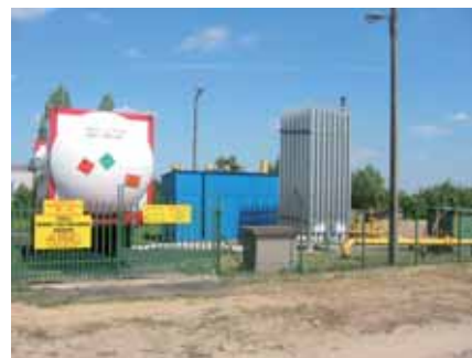
Ryc. 9. Instalacja LNG tymczasowego zasilania. Zasilanie na terenie stacji redukcyjno-pomiarowej I stopnia
