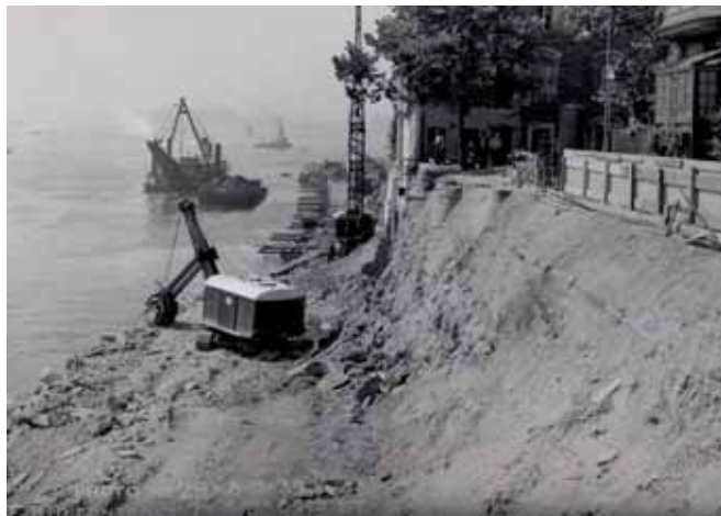
Ryc. 1. Budowa omawianego odcinka drogi na wschodnim brzegu Manhattanu, pomiędzy ulicami 54. a 63. w latach 1939–1940
