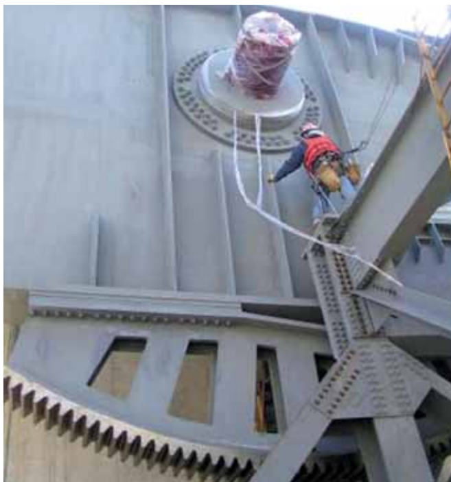
Fot. 8. Montaż jednego z dźwigarów głównych balastowanego prześła podnoszącego. Fotografia daje wyobrażenie rozmiarów tego fragmentu mostu
