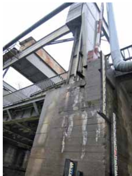
Ryc. 1. Przyciótek. Widoczne zacieki oraz uszkodzenia ściany – korozja zbrojenia
