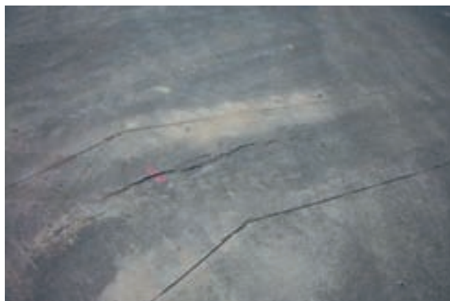
Ryc. 8. Odkrywanie geosiatek w strefie przejściowej jezdni północnej A4 pod uszkodzeniami powierzchniowymi warstwy ścieralnej i wiążącej
