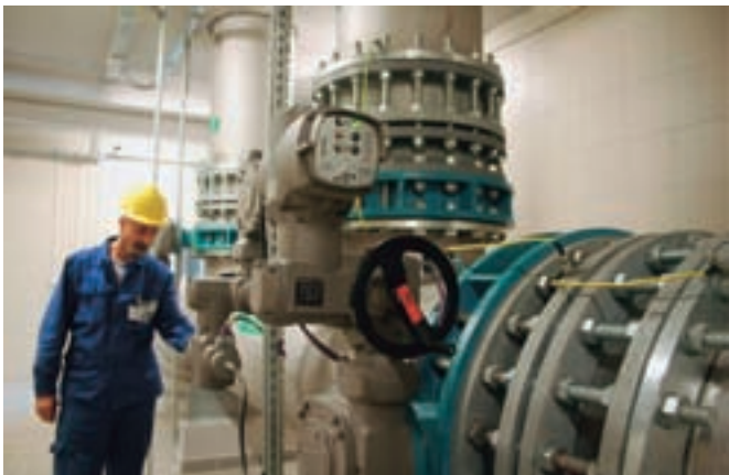
Wnętrze filtrów węglowych Zakładu Uzdatniania Wody „Na Grobli”. Widok na galerię rurociągów, którymi płynie przefiltrowana woda, fot. Krzysztof Czajka
