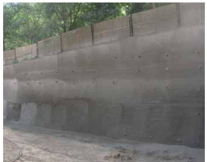
Ryc. 12. Zagwoździowana ściana po narzuceniu torkretu
