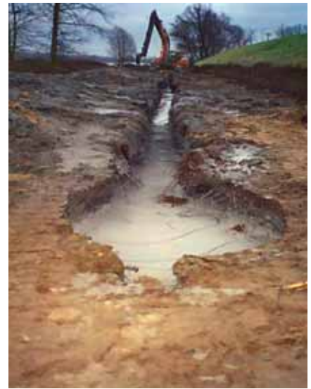
Rys. 6. Głębienie wykopu w trzecim dniu realizacji odcinka próbnego; na pierwszym planie widoczna powierzchnia zawiesziny po stwardnieniu
