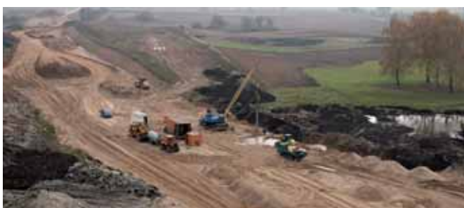
Zagęszczanie gruntu wibroflotacją na wymianie w km 13+150. Odcinek od km 13+036 do km 13+212 po głębokiej wymianie gruntu. Grunt wbudowany zagęszczany metodą wibroflotacji
