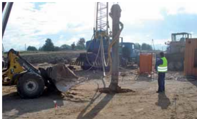
Zagęszczanie gruntu wibracją na wymianie w km 15+150. Zagęszczanie gruntu w wymianie metodą wibracji. Na planie dźwign z wibroflotem, ładowarka z materiałem uzupełniającym, agregat prądowocowy do wibroflotu
