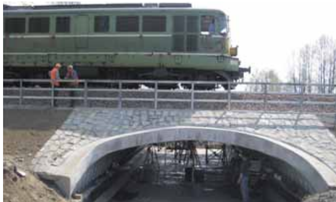
Rys. 9. Badanie konstrukcji gruntowo-powłokowej z blach falistych pod próbnym obciążeniem kolejowym, fot. A. Wysokowski
