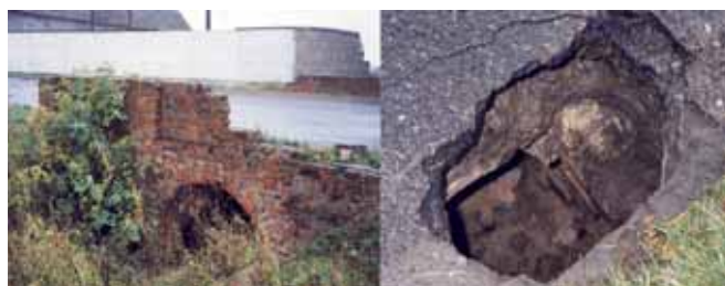
Rys. 12. Przykład uszkodzeń konstrukcji przepustu w skutek złego stanu technicznego i braku jego utrzymania, fot. A. Wysokowski
