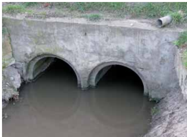
Rys. 5. Zatopiony, dwukomorowy przepust żelbetowy, fot. A. Wysokowski
