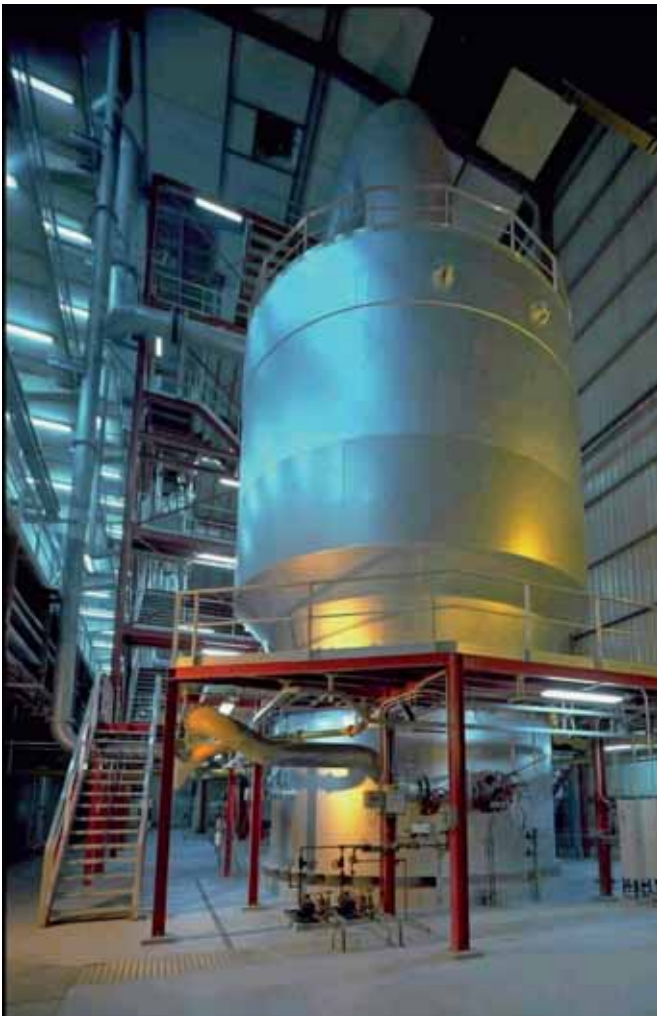
Reaktor termicznego przekształcania osadów ściekowych Pyrofluid™ zainstalowany w oczyszczalni ścieków w Saragossie, fot. archiwum Veolia Water Systems Sp. z o.o.
