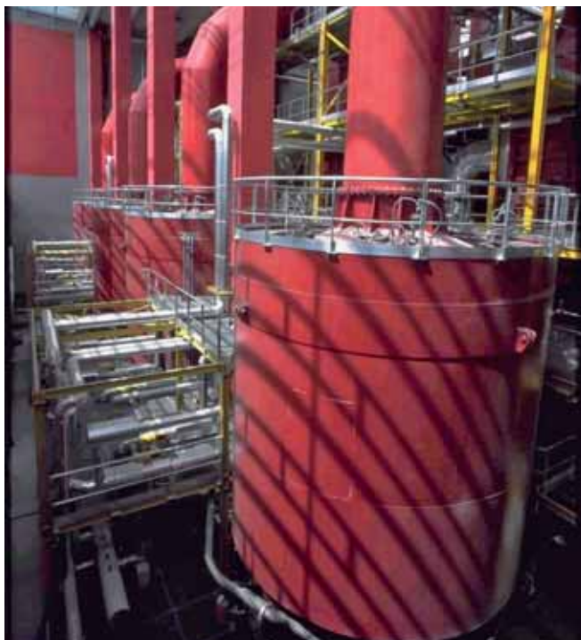
Szereg reaktorów Pyrofluid™ widocznych z galerii wewnątrz budynku technologicznego, oczyszczalnia ścieków Colombes w Paryżu, fot. archiwum Veolia Water Systems Sp. z o.o.
