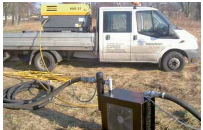
Fot. 5. „Czarna skrzynka” – wentylator schładzający ciepłe powietrze z kompresora
