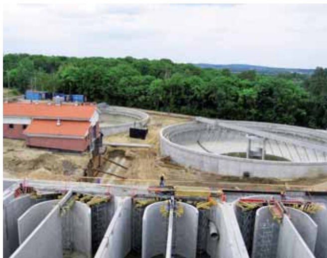
Widok na osadniki wtórne i pompownie osadu
