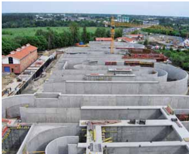
Widok na bioreaktory, kanał technologiczny i budynek dmuchaw
