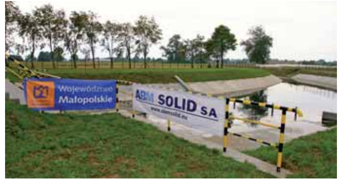
Basen, komora wlotowa oraz fragment zagospodarowanego terenu wokół P-2 „Baška”
