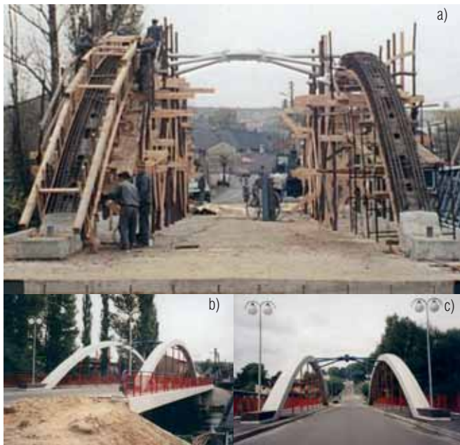
Ryc. 1. Most drogowy nad Wartą w Mstowie: a) widok na rusztowanie i deskowanie łuków, b) widok z boku, c) widok z osi drogi
