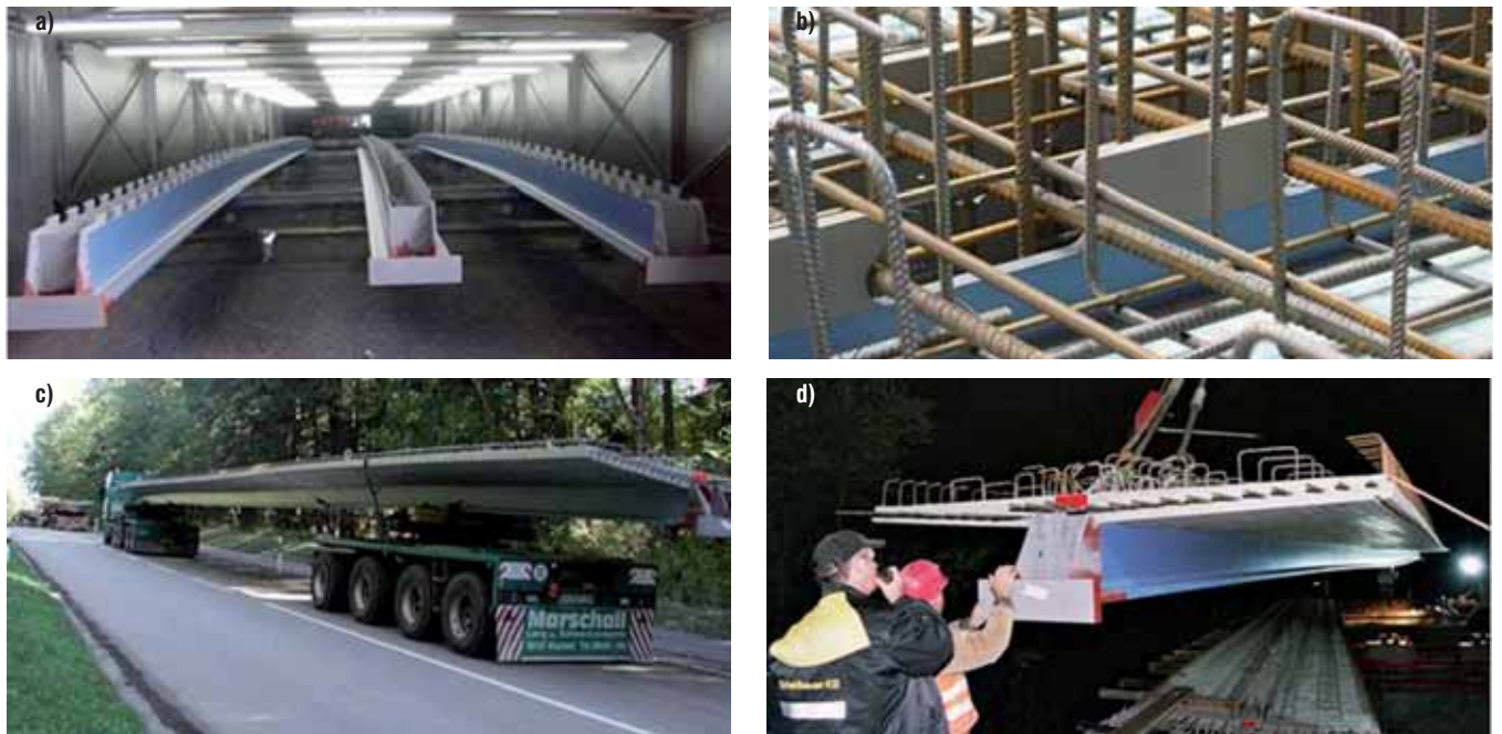
Ryc. 3. Technologia budowy obiektu z dźwigarów VFT-VIB® (wiadukt w Pöcking): a) dźwigary walcowane po przecięciu i zabezpieczeniu antykorozyjnym w warsztacie, b) zespolenie composite dowels płyty prefabrykowanej, c) transport dźwigarów na plac budowy, d) montaż dźwigara o długości 32,5 m (prefabrykat pod dwa przęsła)
