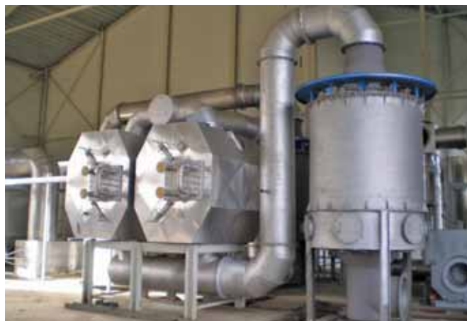
Fragment instalacji do mineralizacji odpadów
