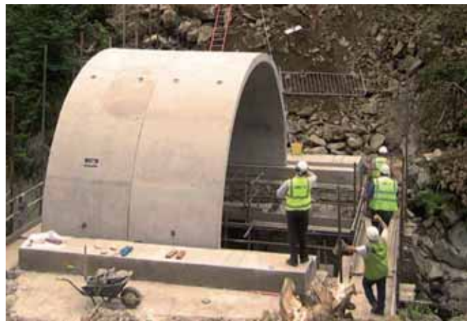
Ryc. 9. Montaż betonowych prefabrykatów do budowy obiektów inżynierskich o przekroju łukowym, fot. Freyssinet Polska
