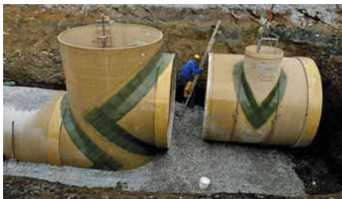
Ryc. 5. Montaż studni kaskadowej; każda studnia kaskadowa była montowana ze zintegrowaną studnią rewizyjną
