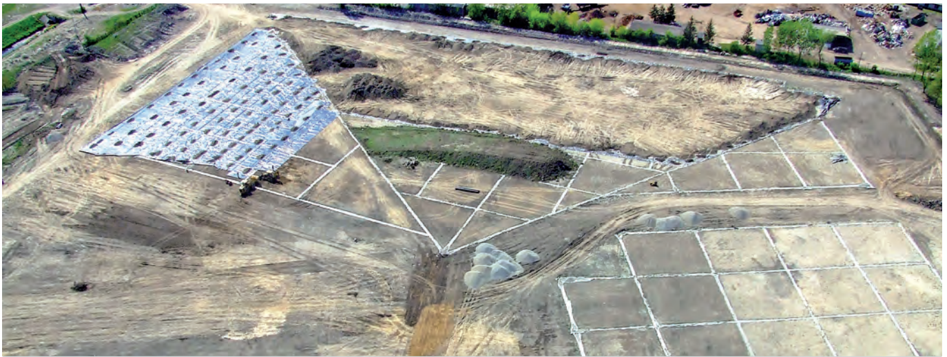
Laguna nr 1 – drenaż odgazowujący
