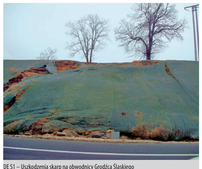
DE S1 – Uszkodzenia skarp na obwodnicy Grodziec Śląski
