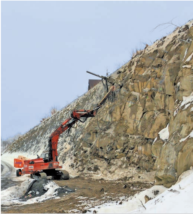
DE S7 – Lubień, widok na trzy różne typy konstrukcji gwoździowanych (ściana oporowa z licem żelbetowym, skarpa z oblicowaniem TECCO, kamieniołom w trakcie prac zabezpieczających)
