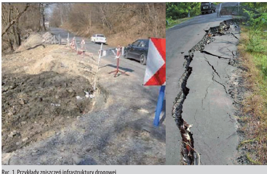
Ryc. 1. Przykłady zniszczeń infrastruktury drogowej
