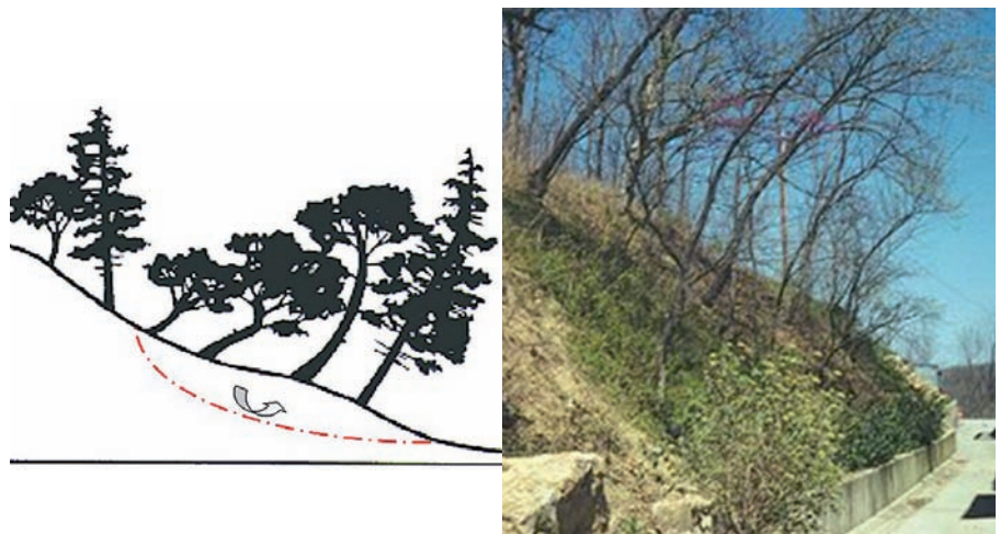
Ryc. 2. Przykład charakterystycznego układu roślinności na skarpie wskazujący na zagrożenie osuwiskiem
