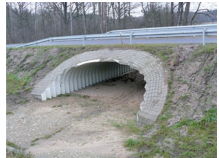
Ryc. 26. Przykład przejścia dla zwierząt o dużej średnicy wykonany ze stalowych blach falistych Multiplate, fot. A. Wysokowski
