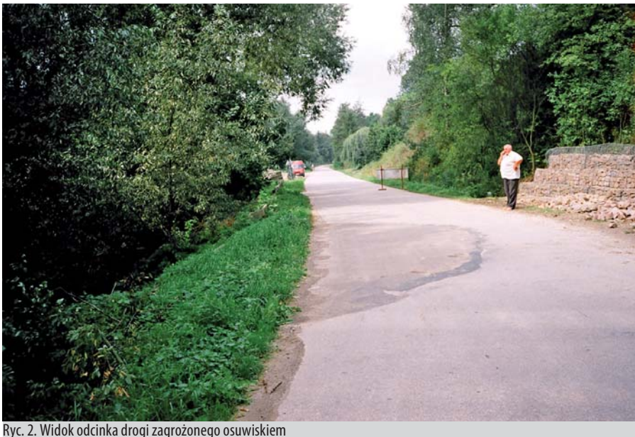
Ryc. 2. Widok odcinka drogi zagrożonego osuwiskiem
