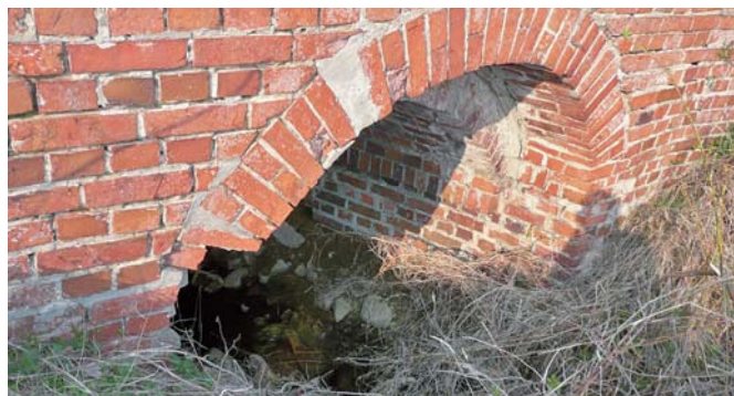
Uszkodzenie konstrukcji nośnej przepustu ceglano-żelaznego
