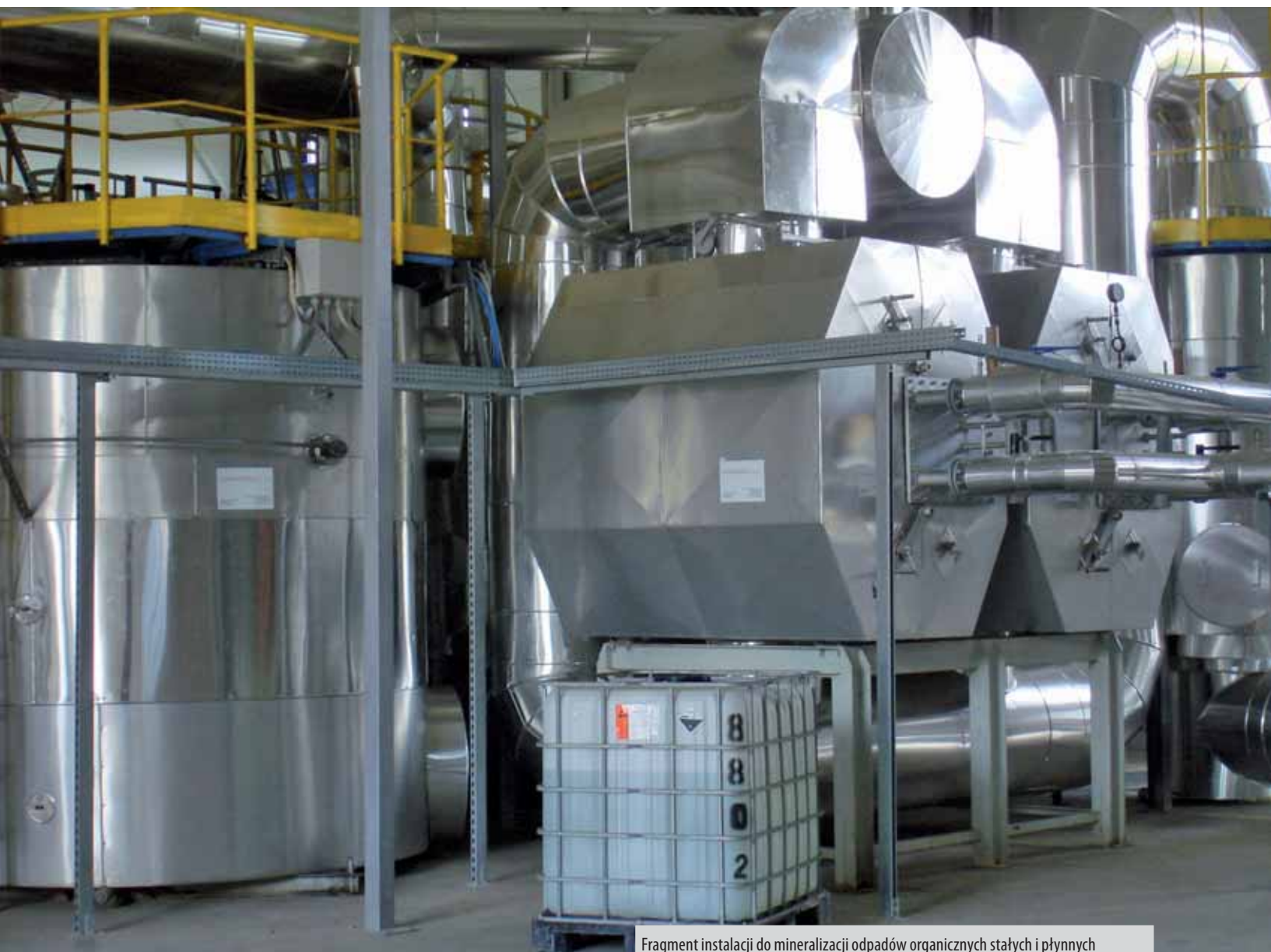
Fragment instalacji do mineralizacji odpadów organicznych stałych i płynnych
