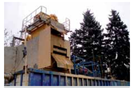
Ryc. 5. System separacji urobku K 36 (ul. Zakroczymska), fot. Z. Rekuć
