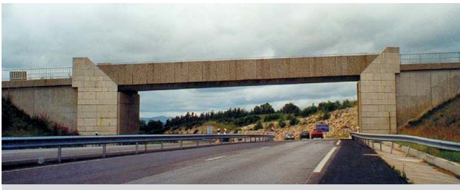
Ryc. 9. Masywne przyczółki wymuszają ciężką balustradę, aby w tym przypadku mogła być spełniona zasada całości i prostoty formy
