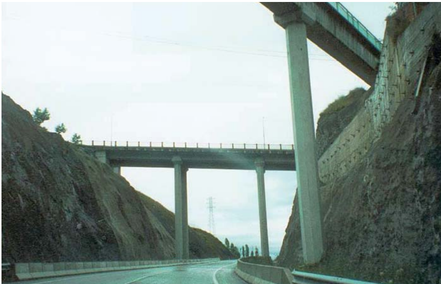
Ryc. 7. Proporcje między rozpiętościami przęseł i wysokością podpór sugerują, że w tym przypadku mogłoby być lepsze rozwiązanie jednoprzęsłowe
