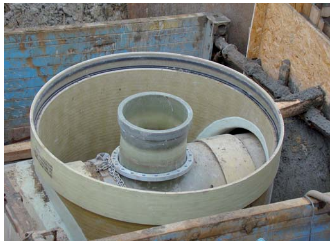
Widok studni dozowania dwutlenku chloru i podchlorynu na SUW „Kalinko”
