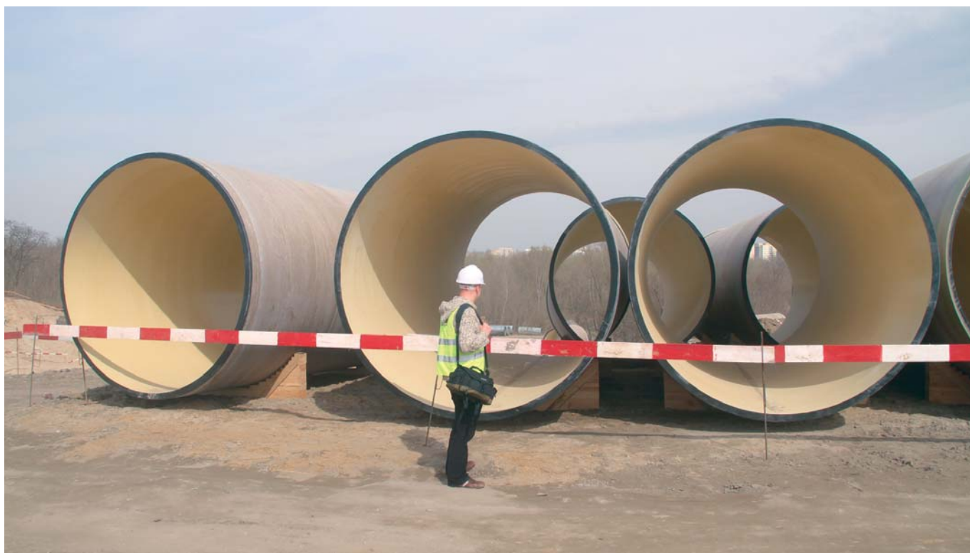
Ryc. 3. Rury Hobas DA3000/DN2800 składowane na miejscu budowy oczyszczalni „Czajka”, fot. Nowoczesne Budownictwo Inżynieryjne
