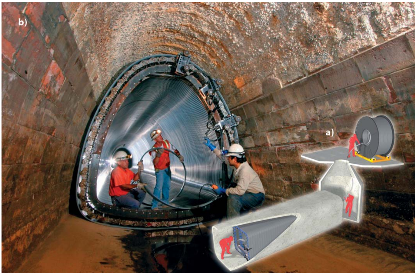
Ryc. 1. Przykłady renowacji z wykorzystaniem wykładzin z rur spiralnie zwijanych SPR: a) schemat instalacji wykładziny w kanale prostokątnym; b) instalacja wykładziny w kanale dzwonowym
