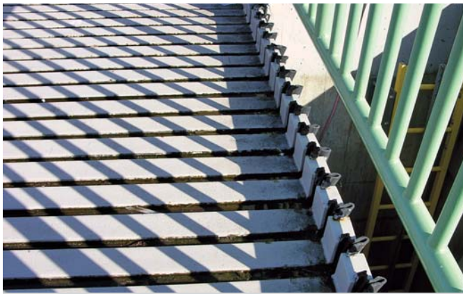
Mechanizm kompensacji odkształceń wzdłużnych mostu Tacoma Narrows, 2007
