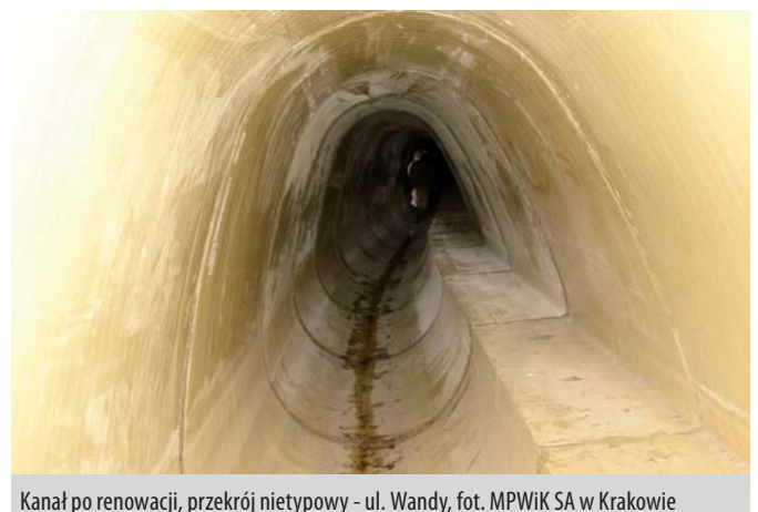
Kanał po renowacji, przekrój nietypowy - ul. Wandy, fot. MPWiK SA w Krakowie
