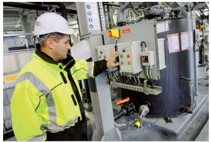
Pracownik STUO przy szafce sterowniczej dozowania chemikaliów, fot. MPWiK SA w Krakowie
