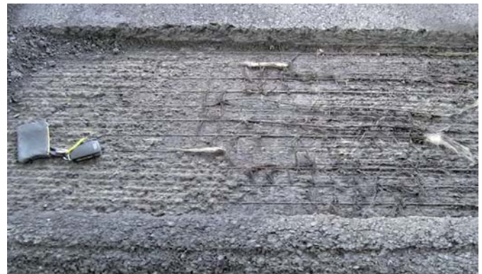
Ryc. 5. Sfrezowany odcinek poletka, od lewej: ponad zbrojeniem, na głębokości zbrojenia, poniżej zbrojenia
