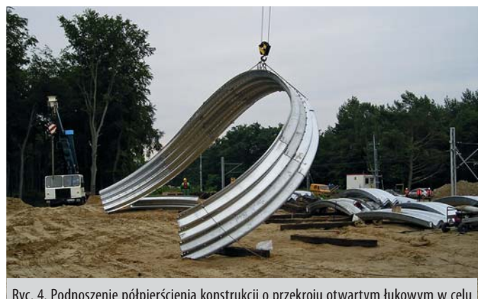
Ryc. 4. Podnoszenie półpręci konstrukcji o przekroju otwartym łukowym w celu umieszczenia go w żądanym miejscu
