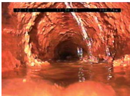
Infiltracja wody gruntowej
