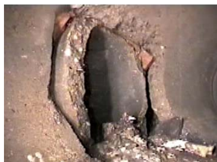
Nieprawidłowo podłączony przykanalik
