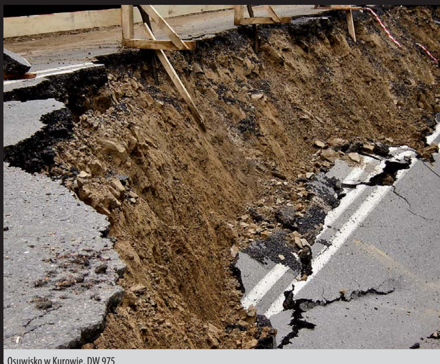
Osuwisko w Kurowie, DW 975
