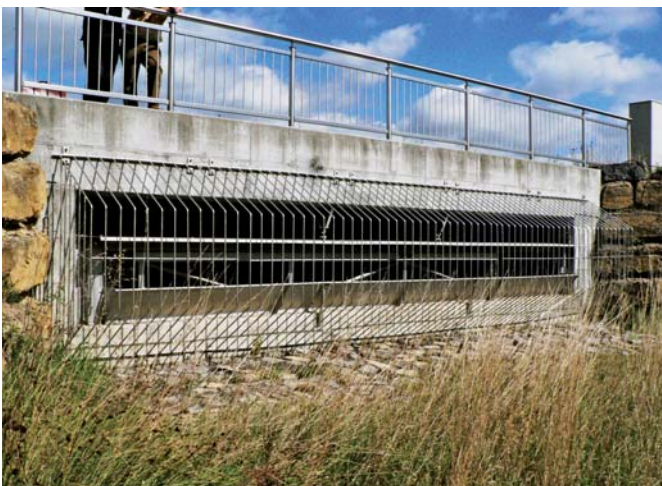
Ryc. 4. Wylot z części podziemnej zbiornika wyposażony w kraty do otwartej komory infiltracyjnej zbiornika z okolic Stuttgartu [8], fot. D. Słyś
