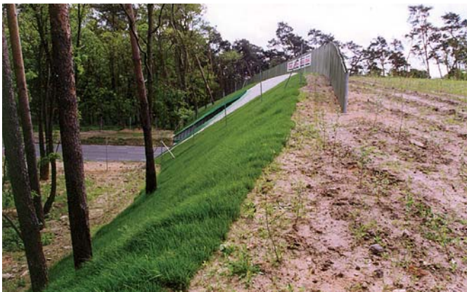
Ryc. 8. Zbyt krótki i niewłaściwie zlokalizowany ekran przeciwoślნიeniowy o nieszczelnej konstrukcji na powierzchni przejścia górnego (droga krajowa nr 5), fot. R. Kurek
