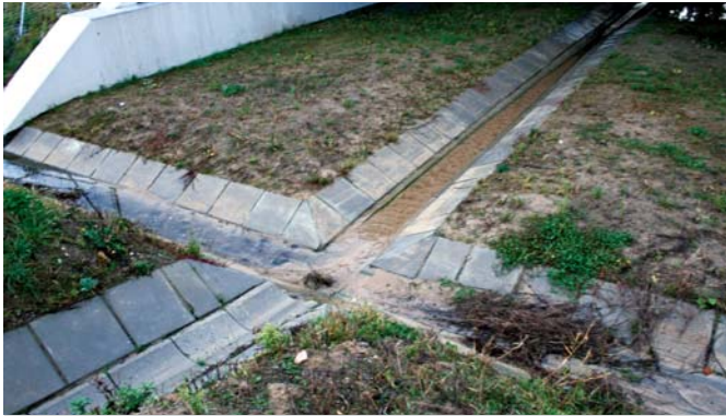
Ryc. 7. Otwarte i umocnione rowy utrudniające przemieszczanie się zwierząt na powierzchni przejścia dolnego (droga ekspresowa S3), fot. R. Kurek
