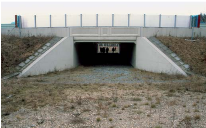
Ryc. 4. Przejście dolne o wymiarach niedostosowanych do wymagań ssaków kopytnych, dodatkowo brak okna doświetleniowego (autostrada A4), fot. R. Kurek
