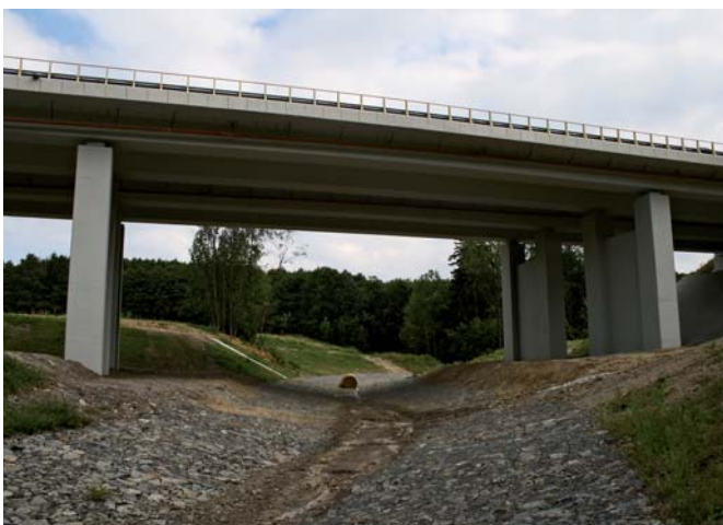
Ryc. 13. Zniszczenie naturalnego koryta potoku przez umocnienia z materacy gabionowych (droga ekspresowa S1), fot. R. Kurek
