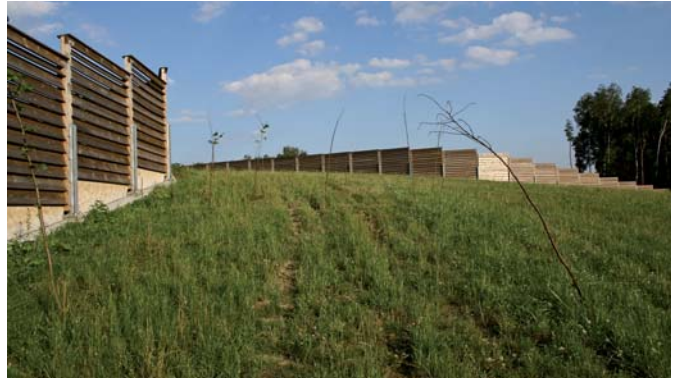
Ryc. 10. Niewłaściwe zagospodarowanie powierzchni przejścia górnego (autostrada A4), fot. R. Kurek
