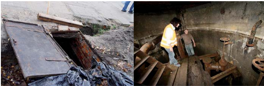
Ryc. 1. Wejście i wnętrze historycznej przepompowni ścieków w Olsztynie, fot. J. Chmura
