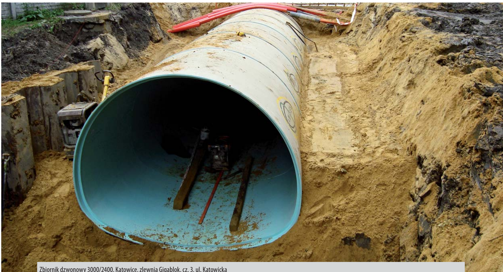
Zbiornik dzwonowy 3000/2400, Katowice, zlewnia Gigablok, cz. 3, ul. Katowicka
