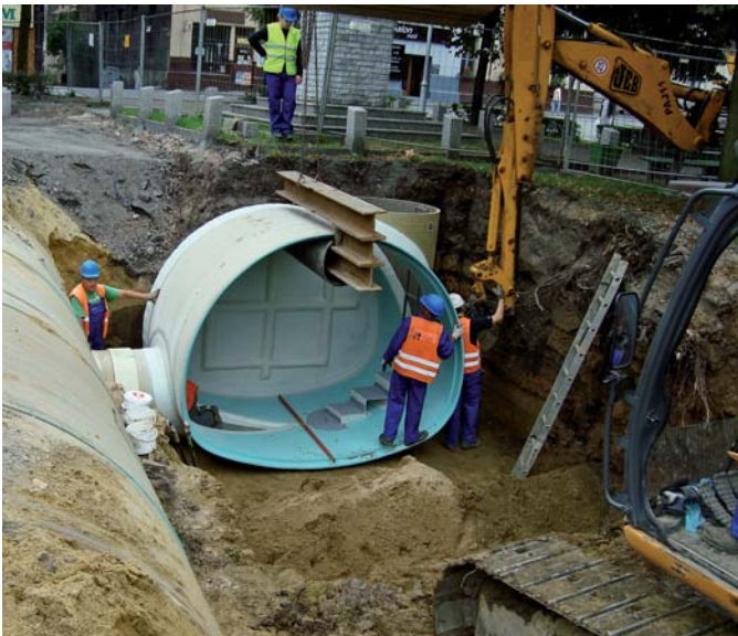
Studnia rewizyjna jako połączenie dwóch zbiorników dzwonowych DN 3000/2400
